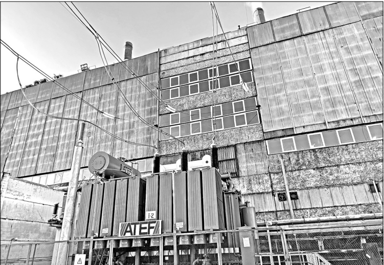
Установлен новый трансформатор Т2. / фото: НГРЭС
